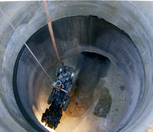
Beheer van rioleringen
