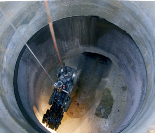
Gestion des réseaux d'égouttage
