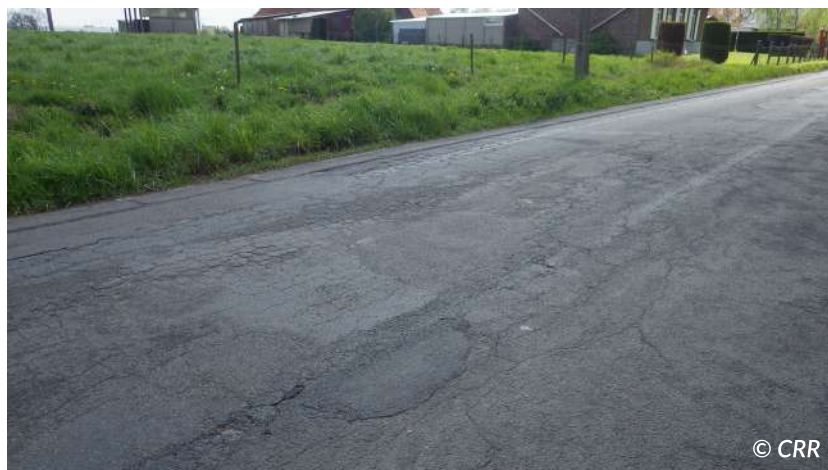
Figure 7.8 – Revêtement routier en fin de vie
