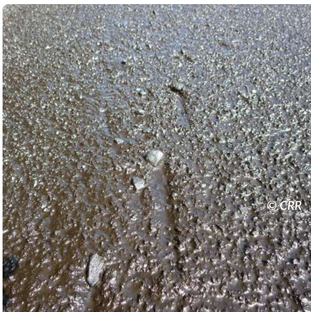
Figure 6.39 – Rainures causées par de gros gravillons juste après la mise en œuvre du MBCF
