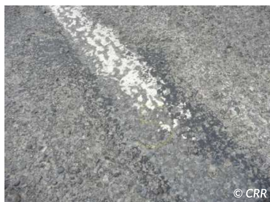
Figure 3.5 - Dégradation au traitement superficiel par des marquages qui n'ont pas été enlevés
