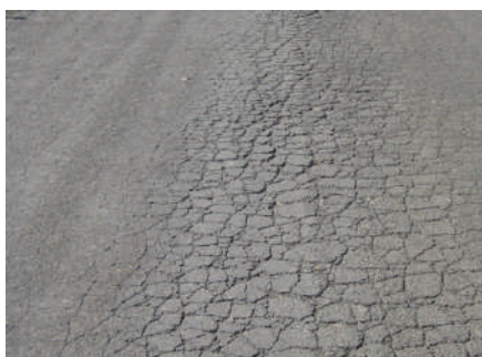
Figure 3.2 – Revêtement avec regroupement de fissures larges (faïençage)
