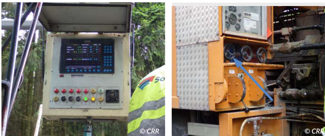
Figure 6.11 – Système de dosage automatique (à gauche) et manuel (à droite)
