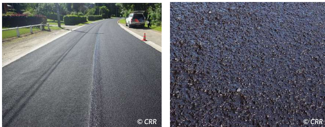
Figure 6.33 – Texture rugueuse juste après la mise en œuvre et avant l'ouverture à la circulation
