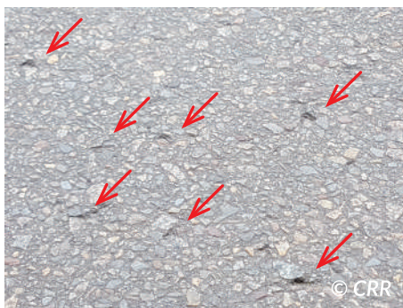
Figure 4.1 - Exemple d'un plumage naissant
