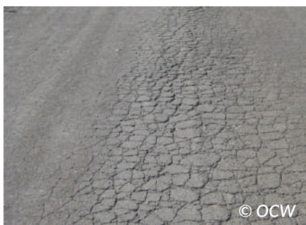
Figuur 3.2 – Wegdek met gegroepede wijde scheuren (netscheurvorming)
