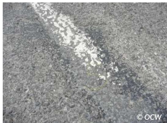
Figuur 3.5 – Schade aan oppervlakbehandeling door niet-verwijderde wegmarkering
