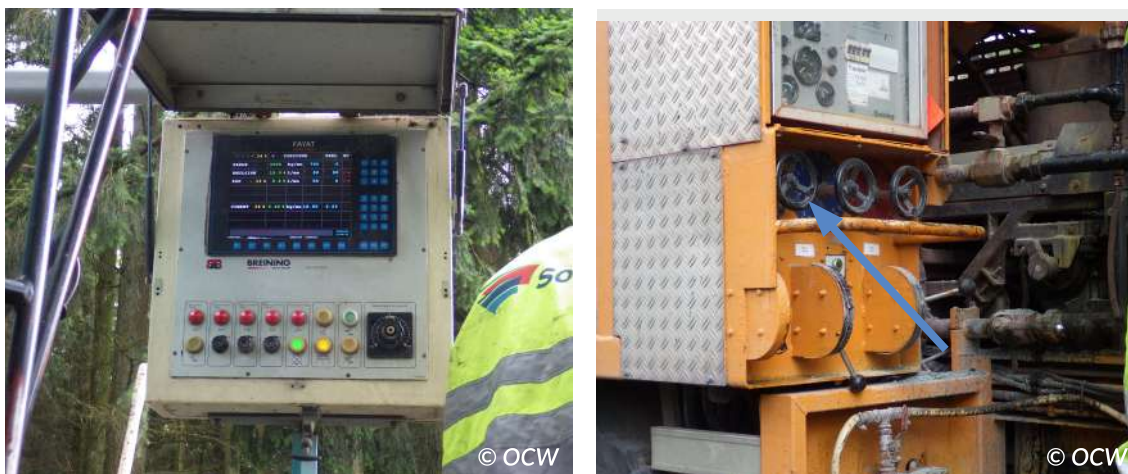
Figuur 6.11 – Automatisch (links) en manueel (rechts) doseringssysteem
