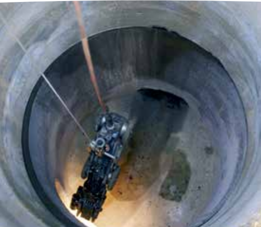
Gestion des réseaux d'égouttage
