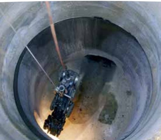
Beheer van rioleringen
