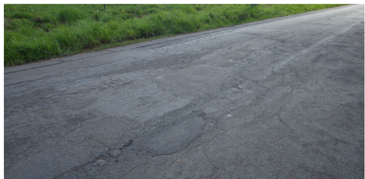
Figuur 3 – Wegdek dat het einde van de levensduur heeft bereikt
