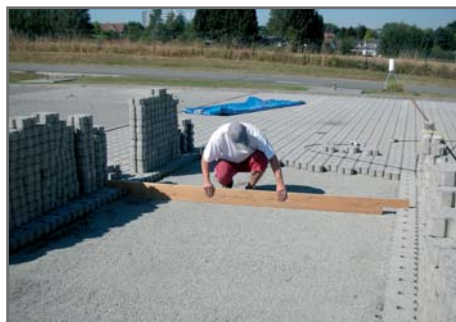
Figure 6.2 Egalisation de la couche de pose à l'aide d'une poutre spécialement sciée
