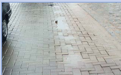
Figure 1.6 Dégradation du pavage due à une infiltration et stagnation d'eau
