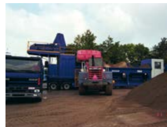
a/ In de menginstallatie
