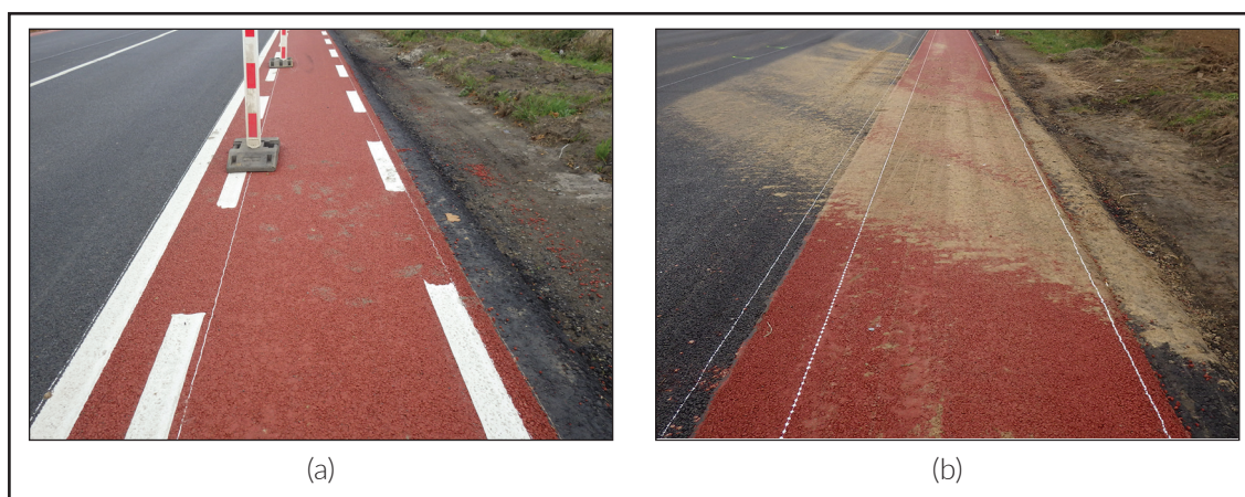
Figure 2.8 – Illustration de deux sections «dégradées» et contaminées par de la terre avec un niveau de sévérité faible (a) et majeur (b)
