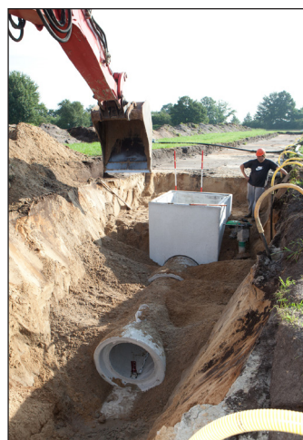
Figuur 6.6 – Omhulling en aanvulling van rioleringsbuis in de sleuf (Bron: René van Dongen)
