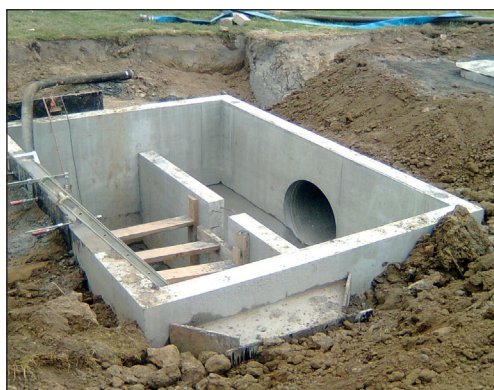
Figuur 8.4 – Overlaatconstructie van ter plaatse gestort gewapend beton (Bron: VLARIO)
