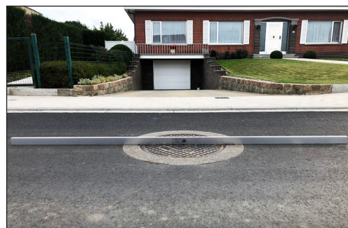
Figuur 8.22 – Controleren van de vlakke aanbrenging van het putdeksel in de bitumineuze verharding met de rei van 3 m (Bron: BNK/Riooldeksel.be)
