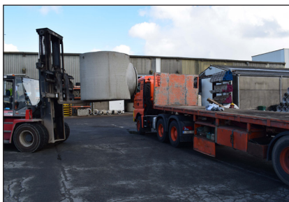
Figuur 2.20 – Hijzen (laden) van put van geprefabriceerd beton met vorkheftruck op een vrachtwagen (Bron: Lithobeton)
