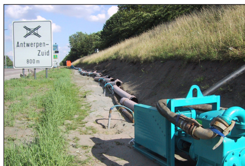
Figuur 3.2 – Waterbeheersing: schoonwaterpomp
