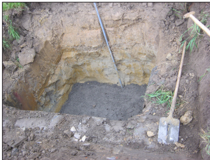
Figuur 8.9 – Plaatsing van een put van geprefabriceerd gewapend beton in de bouwput op een fundering van schraal beton (Bron: VLARIO)
