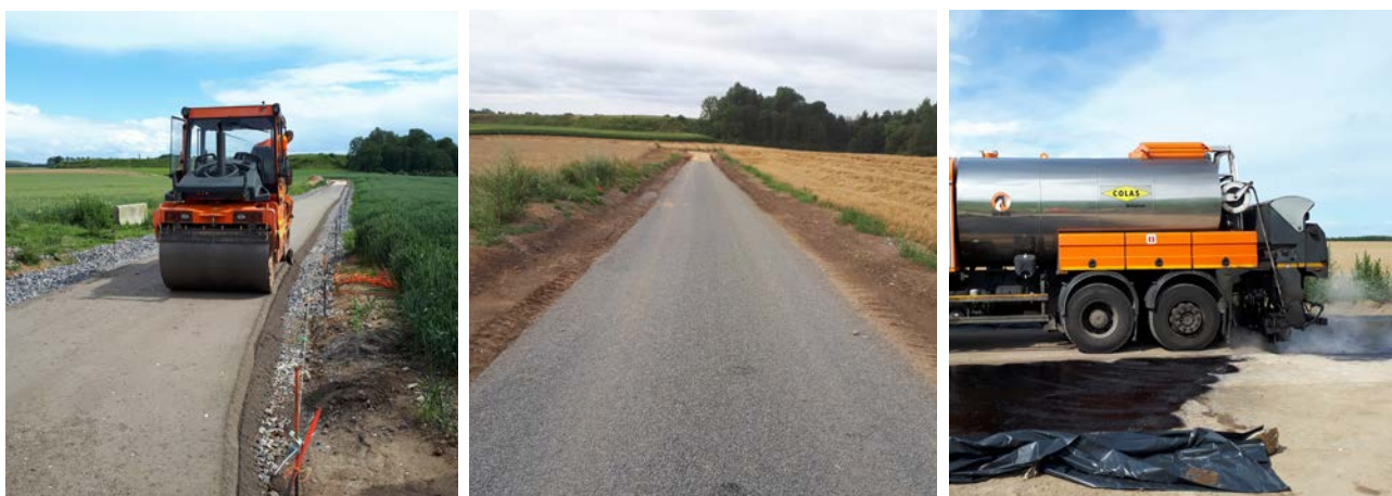
Figuur 10 – Verdichting van het walsbeton, bescherming door aanbrengring van een bitumenemulsie en de uiteindelijke aanbrengring na afstrooien met steenslag
