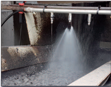
Figure 3 – Ajout du régénérant à l’enrobé au moyen d’un système d’aspersion à volume contrôlé
