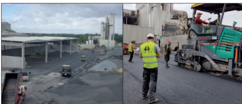
Figure 2 – Pose des sections expérimentales sur le site de production de la nv Stadsbader à Vaulx
