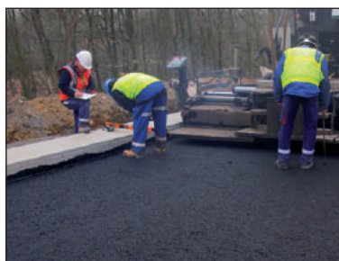
Figure 3.11 – Contrôles de niveau
