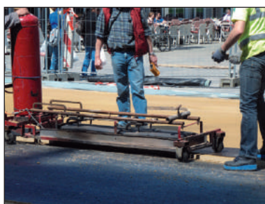
Figure 3.44 – Utilisation d'une rampe de réchauffage pour réchauffer les bords de l'enrobé coloré
