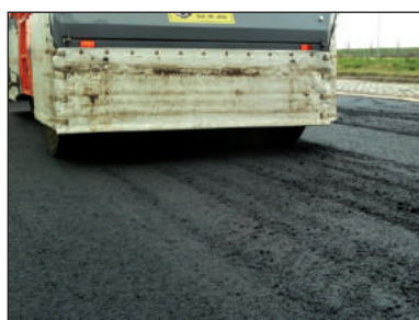
Figure 4.11 – Arrachement de l'enrobé dû à un compacteur dont les pneus sont trop froids
