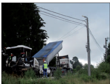
Figure 2.1 – Danger avec des câbles électriques
