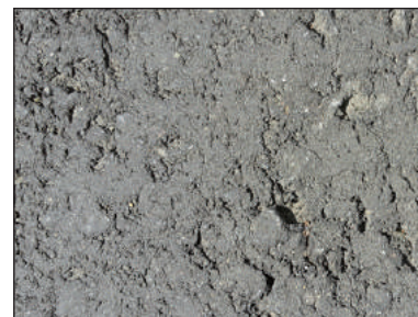
Figure 7.2 – Microfissuration d'un enrobé compacté à température trop basse
