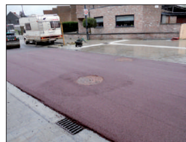
Figure 4.7 – Contamination après compactage
