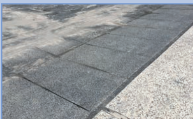
Schade ten gevolge van pompeffect
