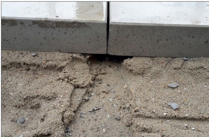
Figuur 4.2 – Voorbeeld van uitspoeling van de straatlaag bij gebrek aan kantopsluiting
