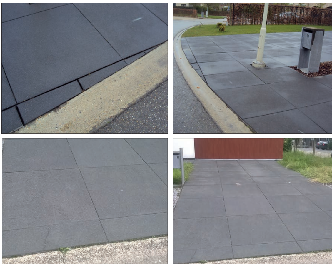
Figuur 9.12 – Schade door onzorgvuldige afwerking aan de randen van de verharding
