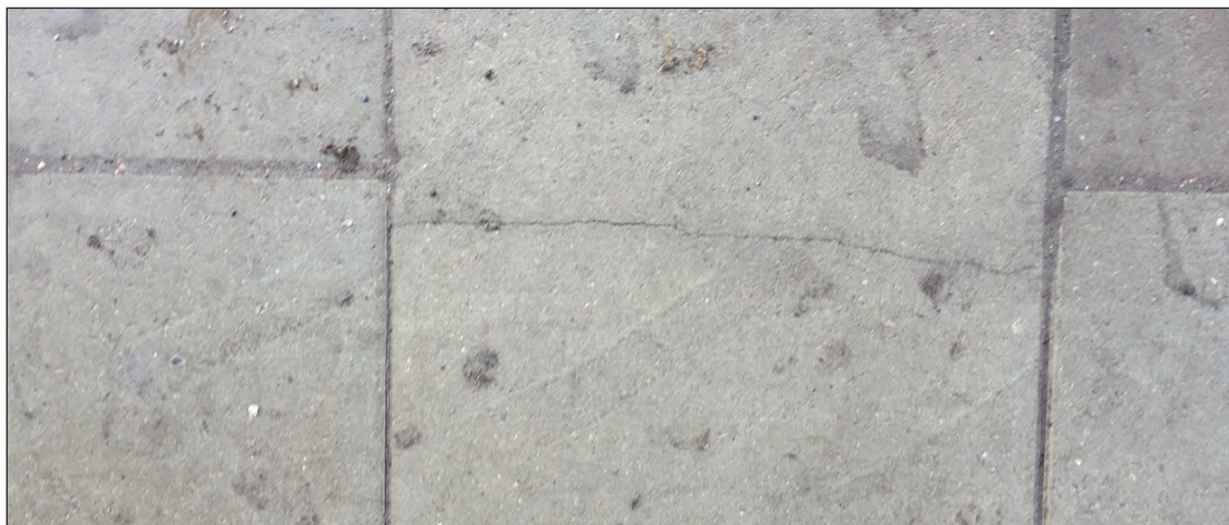
Figuur 9.9 – Breuk vastgesteld in de tegels uit figuur 9.8
