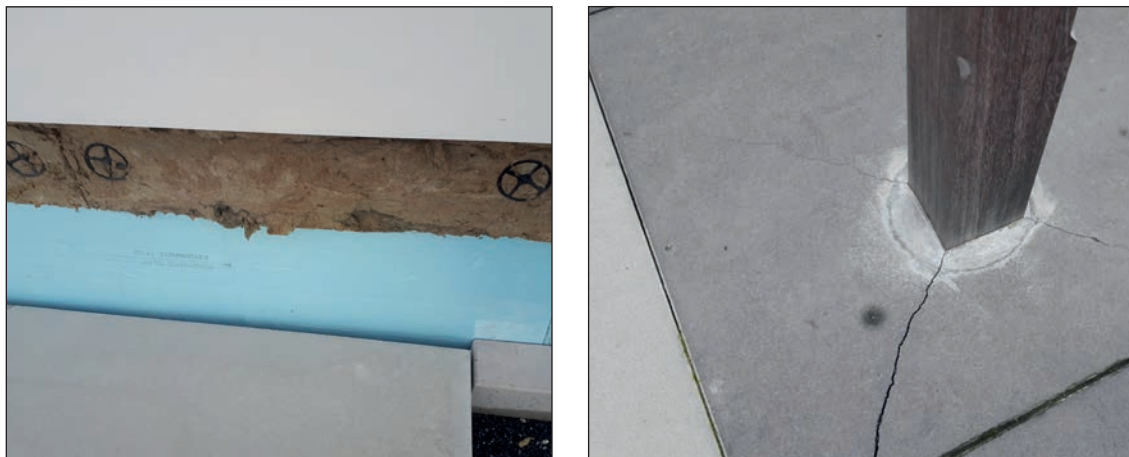
Figuur 4.22 – Voorbeeld van isolatievoeg en mogelijke schade indien ze niet rond singuliere punten wordt toegepast
