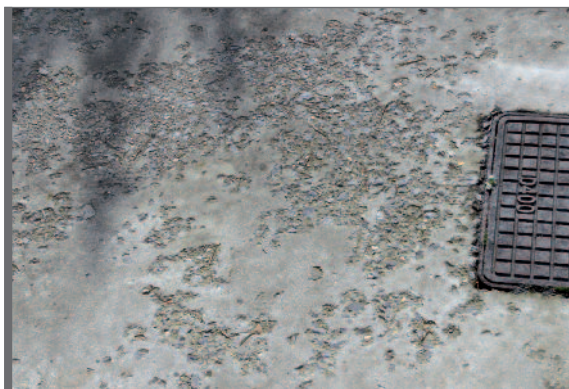
Figure 6.8 Ecaillage superficiel dû aux sels de déverglçage
