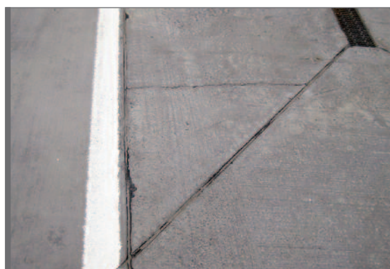
Figure 6.3 Fissure due à un angle aigu
