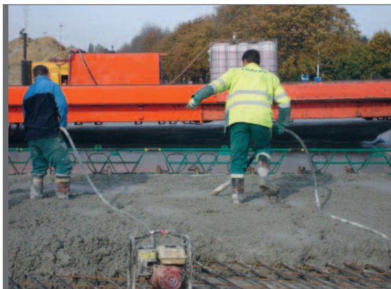
Figure 3.16 Mise en œuvre entre coffrages fixes avec compactage aux aiguilles vibrantes et à la poutre vibrante
