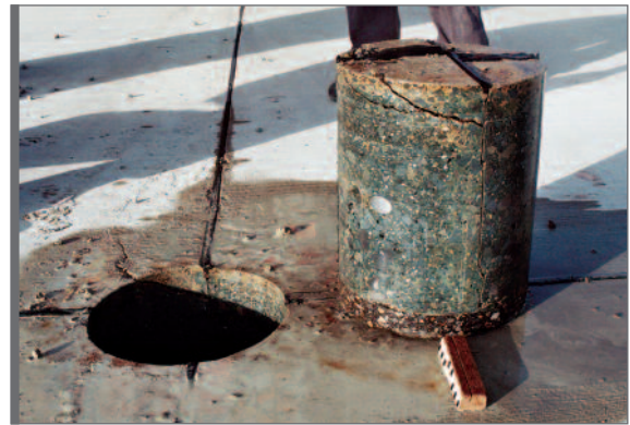
Figure 6.6 Joints sciés sur une profondeur insuffisante
