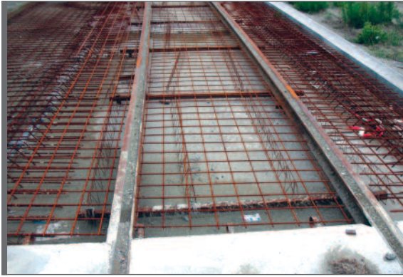
Figure 4.2 Rails encastrés dans le béton
