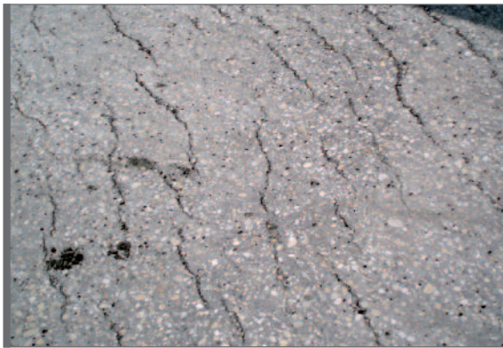
Figure 6.5 Fissures dues au vent
