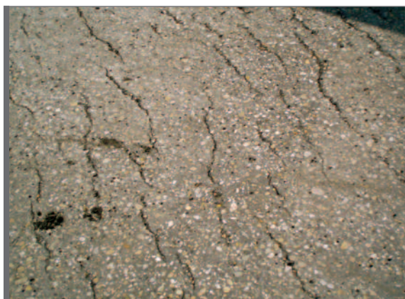
Figure 3.24 Fissuration sous l'effet du vent
