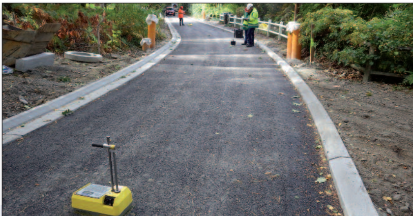
Figuur 1 – Uitvoering van vergelijkende metingen met nucleaire en elektromagnetische dichtheidsmeters in een testzone
