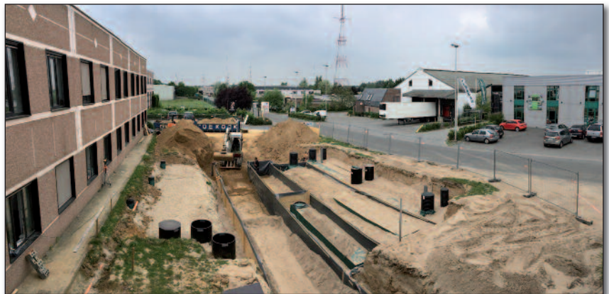
Figuur 2 – Proefinstallatie in onze vestiging te Waver
