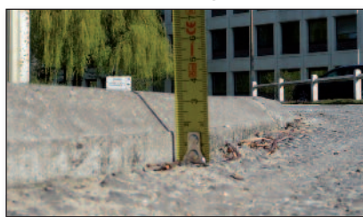
Figuur 1 – Niet-conforme overgang (met verticale verhoging) aan een fietsoversteekplaats
