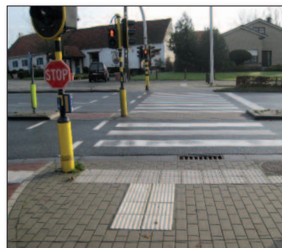
Figuur 3 – De rioolkolk in de oversteekplaats vormt een obstakel voor de weggebruikers
