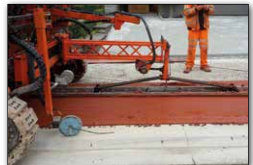
Figure 8 – Utilisation d'un supersmoother lors de la réalisation d'une piste cyclable en béton
