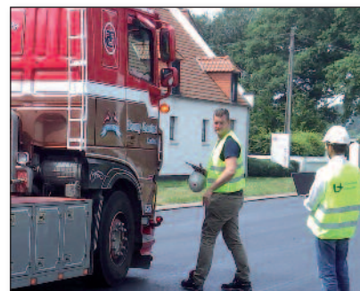
Figure 4 – Le camion arrive sur le chantier, ce qui est signalé dans le système
