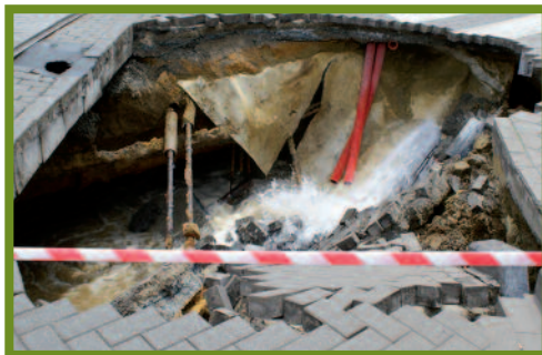
Ernstige schade door een ingestorte rioolleiding
