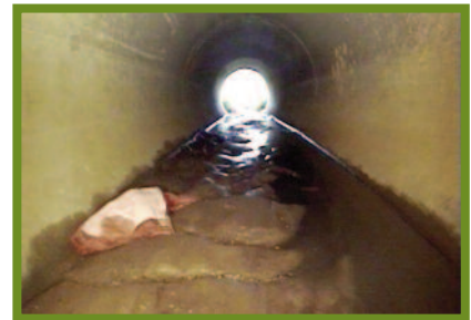
Bezinken afzetting door modderinstroom langs een rioolput tijdens de aanleg; afdekken kan extra kosten voorkomen
