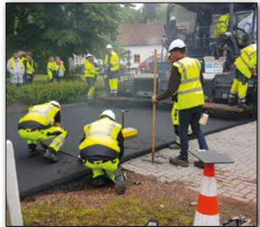
Figuur 1 – Monitoring van de aanleg van de proefvakken met gebruik van verjongingsmiddel op de N123 (Retie – Kasterlee) te Retie
