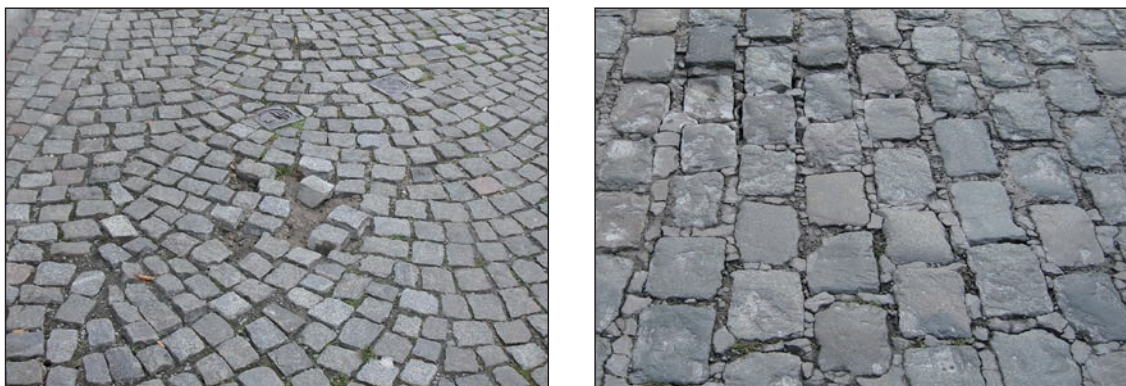
Figuur 5.8 – Voorbeelden van plaatselijke vervormingen door onzorgvuldige uitvoering en/of gebreken in het ontwerp
