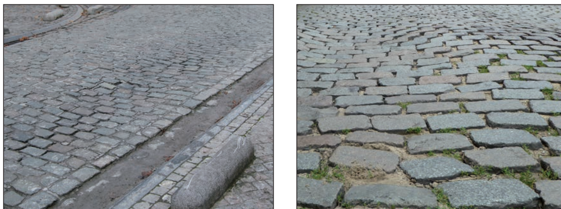
Figuur 5.6 – Voorbeelden van spoorvorming en "pompeffecten" in een natuursteenverharding
