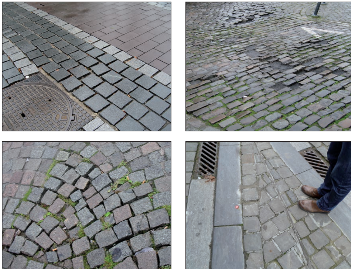
Figuur 5.4 – Voorbeelden van verlies van constructieve samenhang van de verharding door te brede voegen, een onaangepast bestratingsverband, gebrek aan kantopsluiting en/of onzorgvuldige afwerking aan de randen en rond singuliere punten
