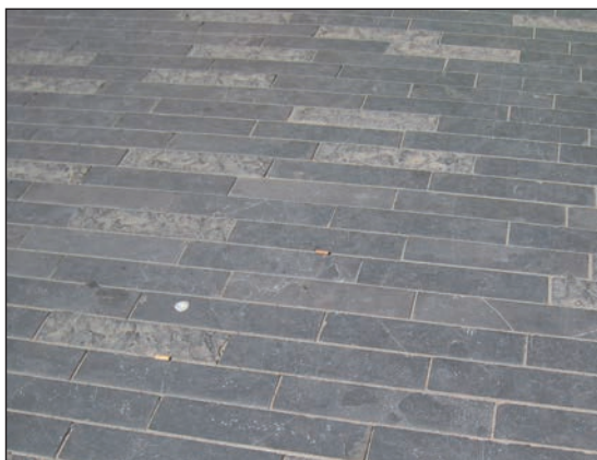
Figuur 3.29 – Natuursteenbestrating met afwisselend gepolijste en onbewerkte straatkeien. Aan de gepolijste oppervlakken te zien blijft er gevaar om uit te glijden 6
