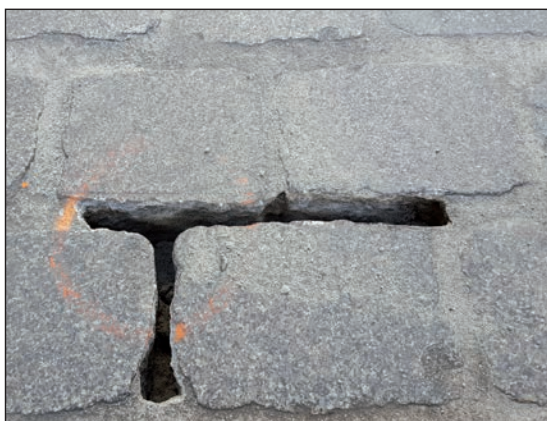
Figuur 5.17 – Lokale schade aan voegen in een natuursteenverharding (Foto: Febenat)
