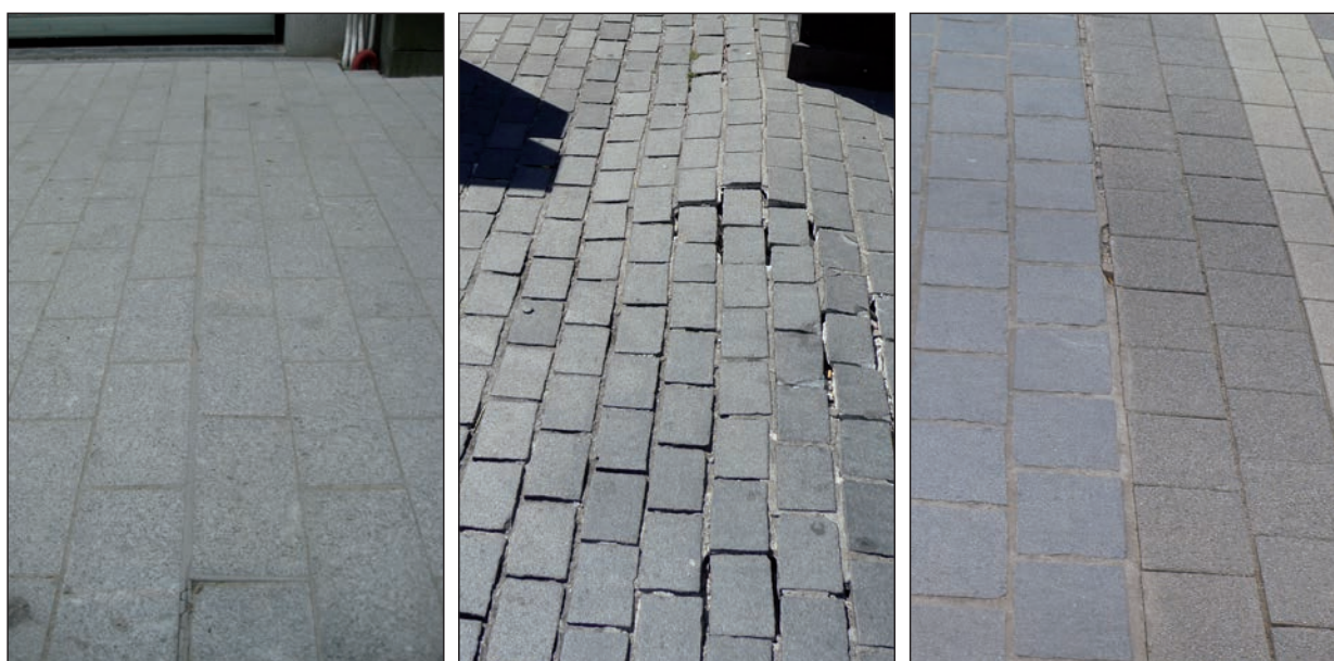
Figuur 5.7 – Voorbeelden van langsonvlakheid en schade, te wijten aan thermische bewegingen en/of aansluiting op andere verhardingen
