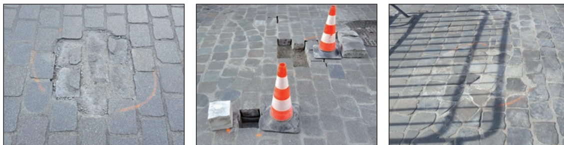
Figuur 5.18 – Tijdig herstellen van lokale schade aan natuursteenverhardingen door vervanging van beschadigde elementen (Foto's: Febenat)
