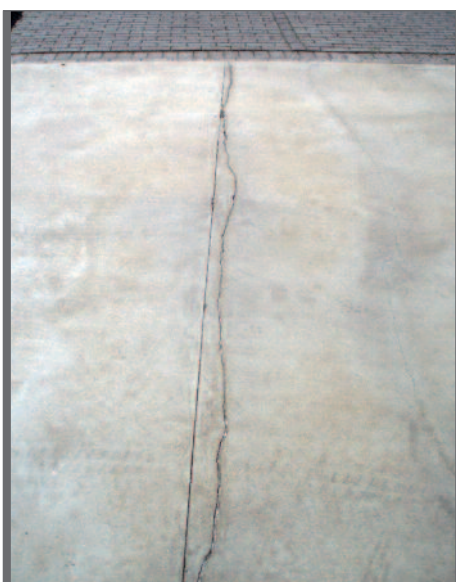
Figuur 6.2 Te laattijdig gezaagde voegen
