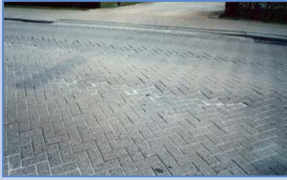
Figuur 1.7 Fijn materiaal aan oppervlak ten gevolge van pompen
