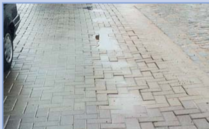
Figuur 1.6 Schade ten gevolge van pompeffect
